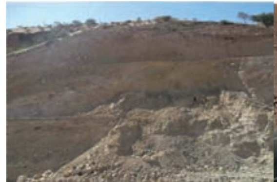
Разрушение откосов при сооружении полук
