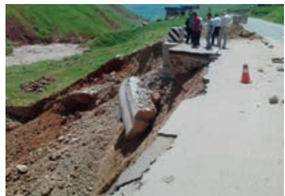
Разрушенный участок горной дороги
