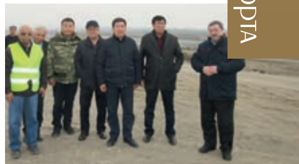
Экс-министр, действительный член Международной академии транспорта Айдаров З.К. на реконструкции автодороги «Бишкек-Ош»
