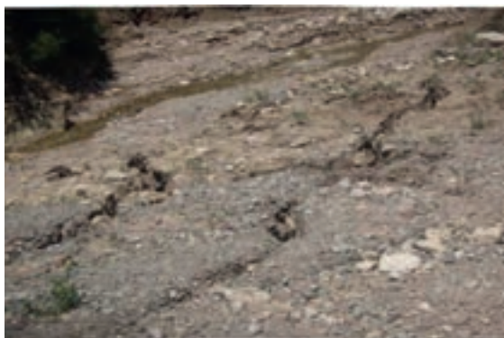
Появление трещины на поверхности земли
