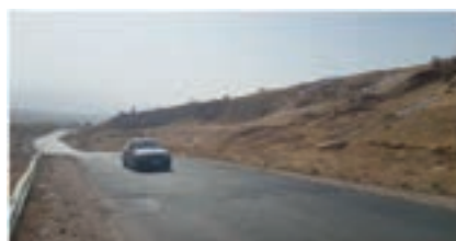
Оползневый участок автомобильной дороги
